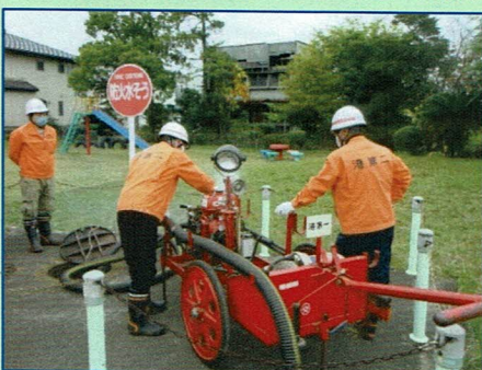
可搬式ポンプ点検
